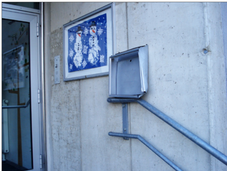
Die Überreste des Briefkastens der Sonderschule, der vermutlich durch Feuerwerkskörper gesprengt worden ist.
